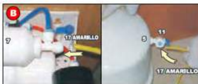
POSTFILTRO DEPÓSITO ACUMULADOR
